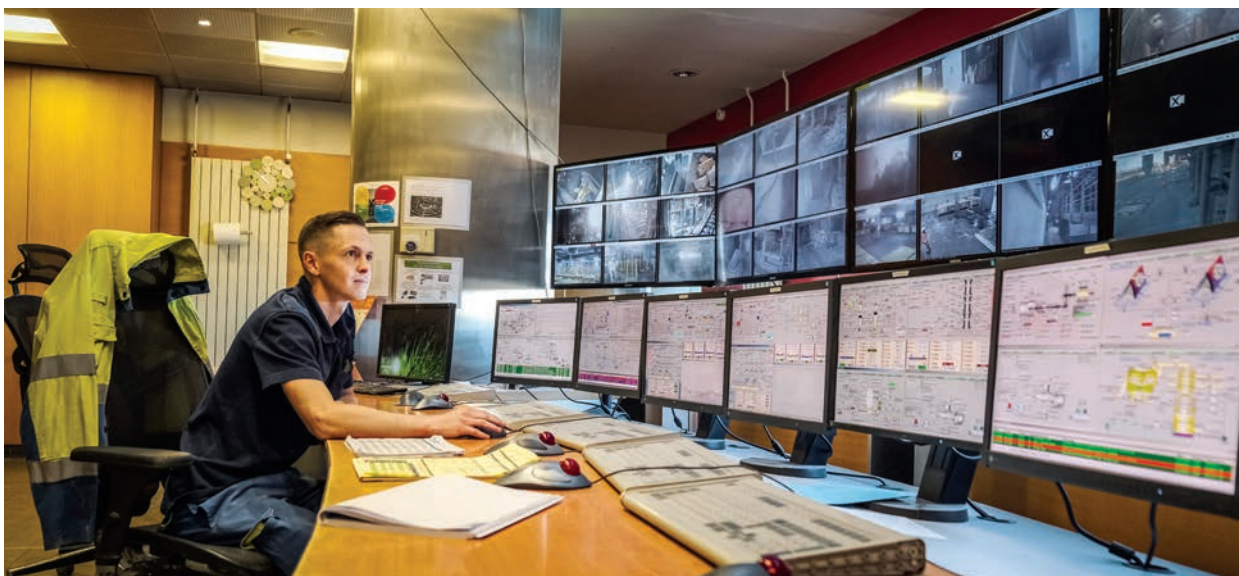
Salle de pilotage de l'unité de valorisation énergétique de Valo'Marne.
