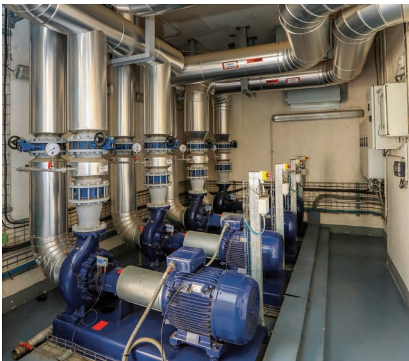
Les pompes de distribution permettent d'acheminer l'eau chaude depuis les centrales de production jusqu'aux bâtiments raccordés.
