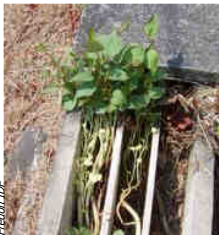
Renouée poussant dans l'emprise de la voie ferrée
